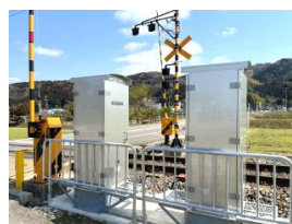
制御器・電源機器
