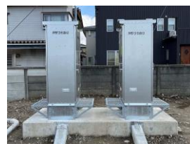
制御器・電源機器
