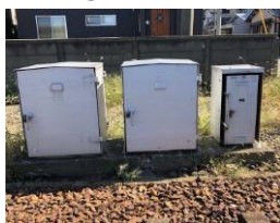
制御器・電源機器
