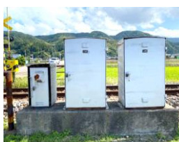
制御器・電源機器
