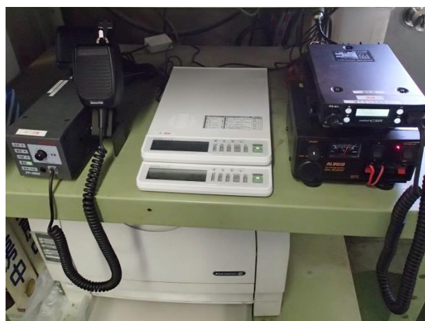
浅野川線 列車無線設備
