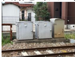
制御器・電源機器
