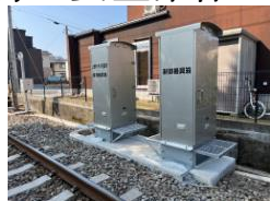
制御器・電源機器
